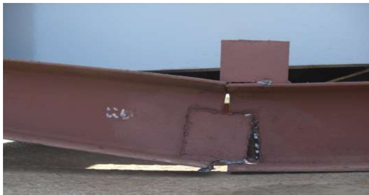
Défaut de soudage
