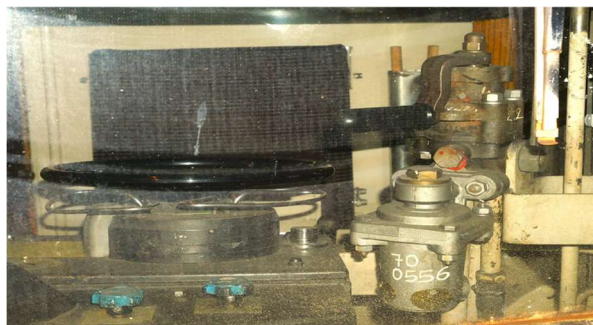
Vue du poste de conduite
