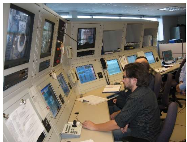
...et la salle de contrôle
